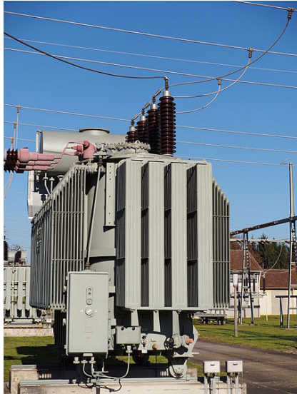
Figuur 1: Transformator voor de omzetting van 120kV naar 20kV Bron: Kreuzschnabel/Wikimedia Commons, Licentie: CC-by-sa-3.0
